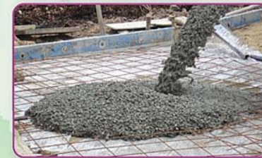
ลักษณะการเทคอนกรีตที่ไม่ถูกต้อง
