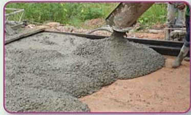
การเทคอนกรีตที่ถูกต้องจะไม่มีกรเหยียบย่ำคอนกรีต
