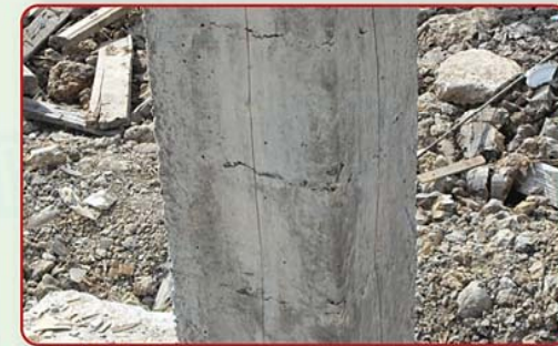
การใช้คอนกรีตที่มีการเยิ้มมากเกินไป
