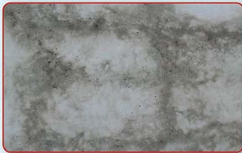
ผิวคอนกรีตที่ใช้แบบหล่อไม่สะอาด
