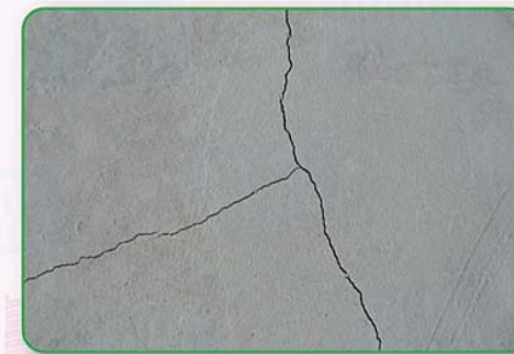
การแตกร้าวของคอนกรีตเนื่องจากการสูญเสียน้ำ
