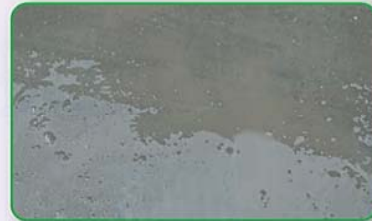
ผิวคอนกรีตที่มีการจี้เยาะมากเกินไป
