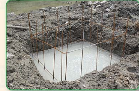
กันหลุมมีน้ำขังอาจทำให้เหล็กเสริม เกิดสนิมได้
