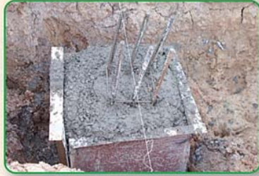
การเตรียมเหล็กเสริมที่ไม่ถูกต้อง
