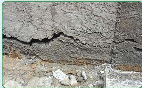
การทรุดตัวของฐานรากจากการบดอัดดินไม่แน่น
